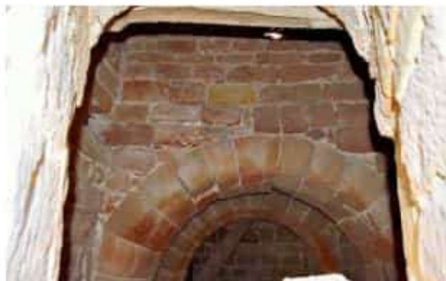
Der Blick auf die tragenden Rundbögen im Erdgeschoss des Turms der Kirche zeigt den bestehenden Sanierungsbedarf.
