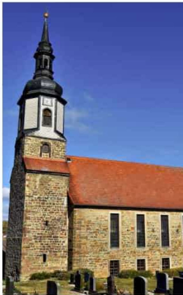
Außerlich zeigt der Kirchturm St. Jacobi einen soliden Eindruck, die Schäden offenbaren sich jedoch im Inneren des Turms.
